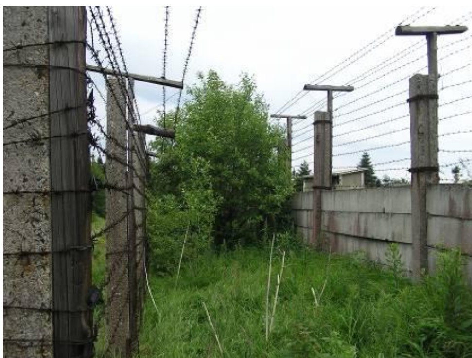
Obr. – ukázka stavu bývalé signální stěny na stanovišti Dyleň. (2005). V současnosti funguje už jen jako mechanický plot bez elektroniky.
